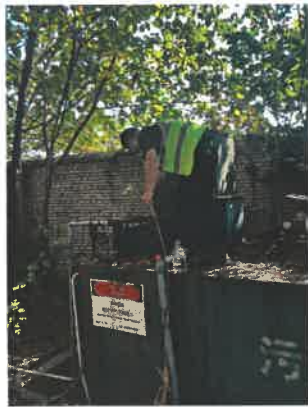
污水处理设施排口
